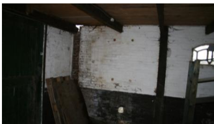
Figuur 3.4, gaten in de muur (notie: dit betreffen niet de enige gaten)
